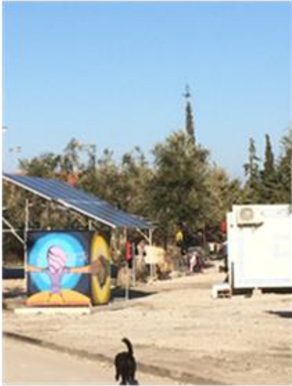
Solaranlagen zur Warmwasseraufbereitung im Lager Karatepe
